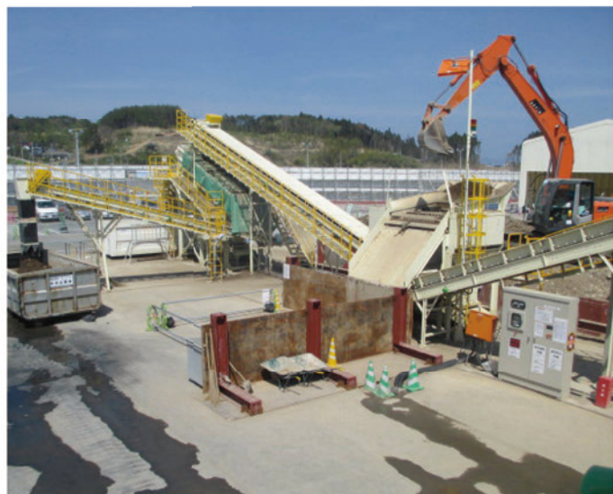
気仙沼の震災廃棄物処理プラント
